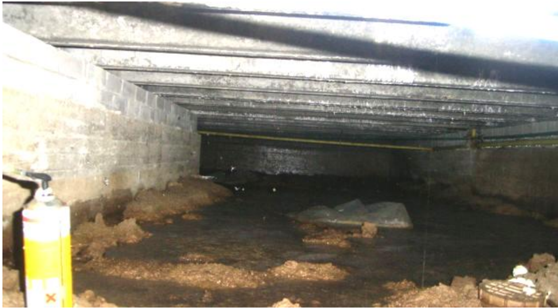
Kruipruimte met kweekvloer. Kruipruimte heel vochtig, gasleiding roestig?
